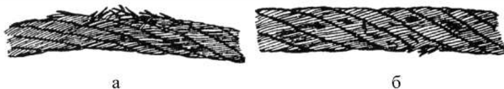
Рис. 3. Обрывы проволок в зоне уравнительного блока: а – в нескольких прядях каната; б – в двух прядях в сочетании с местным износом
